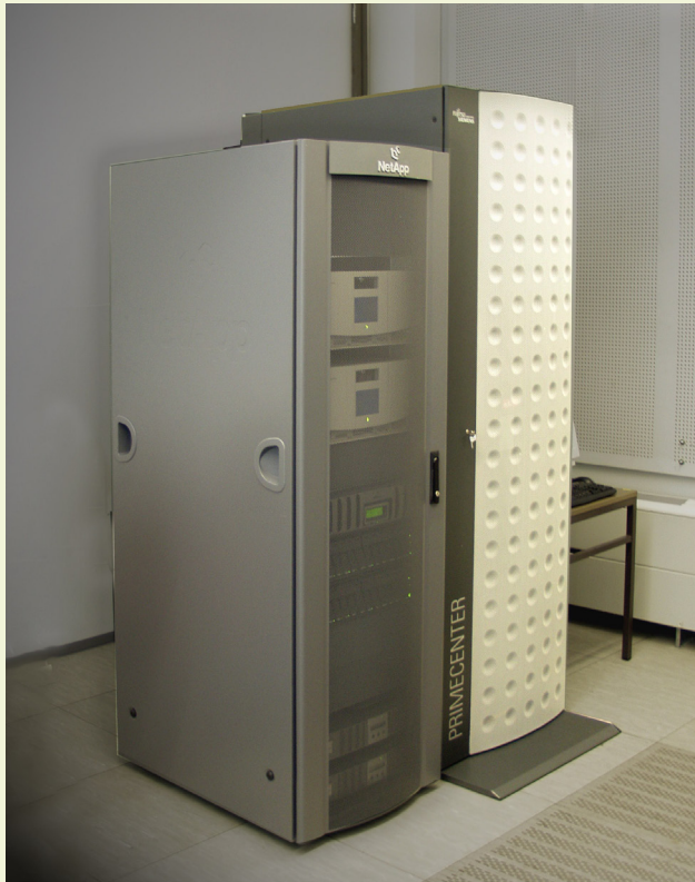
Abb. 15: Filer1 und Backupsystem in Maschinensaal II
