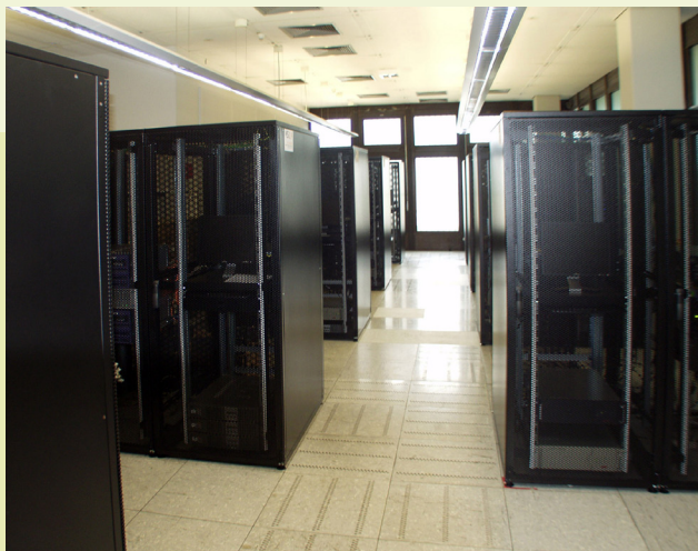
Abb. 12: Der Maschinensaal I in Gebäude P.05
