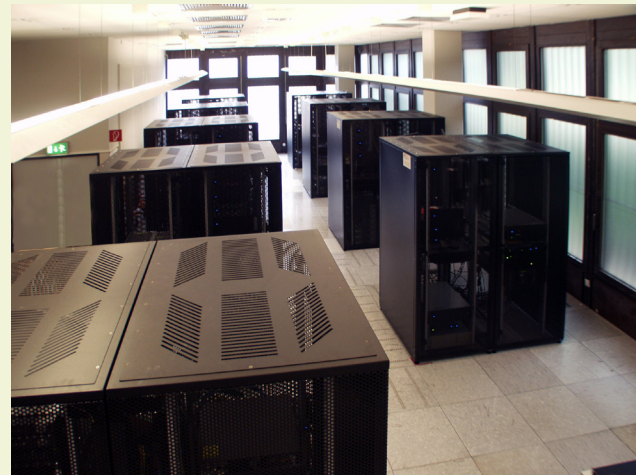
Abb. 13: Blick über die Racks in Maschinensaal I
