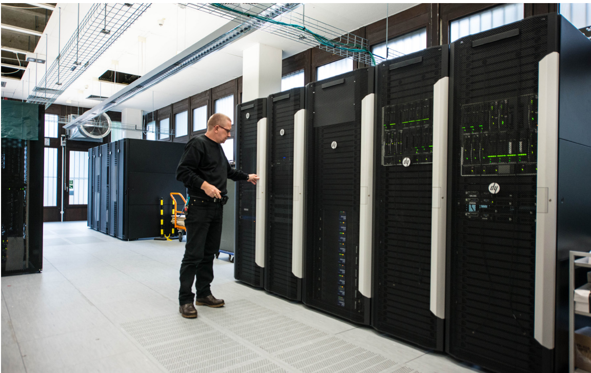
Abb.: 20. Der Maschinensaal I in Gebäude P.05
