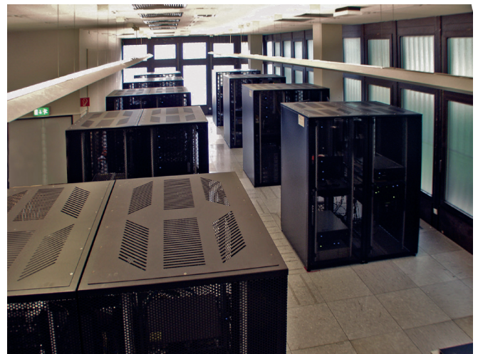
Abb.: 15. Blick über die Racks in Maschinensaal I
